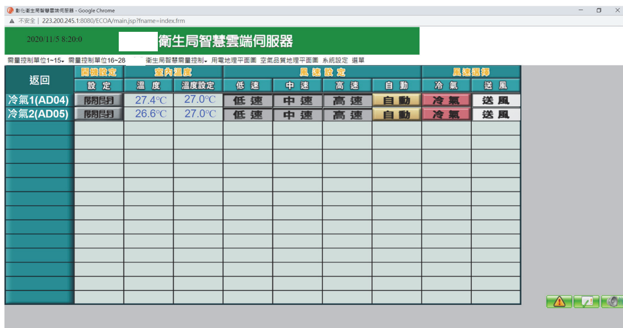
圖 2-20 某 C 縣所轄某處衛生所需量卸載前之空調系統為冷氣模式
