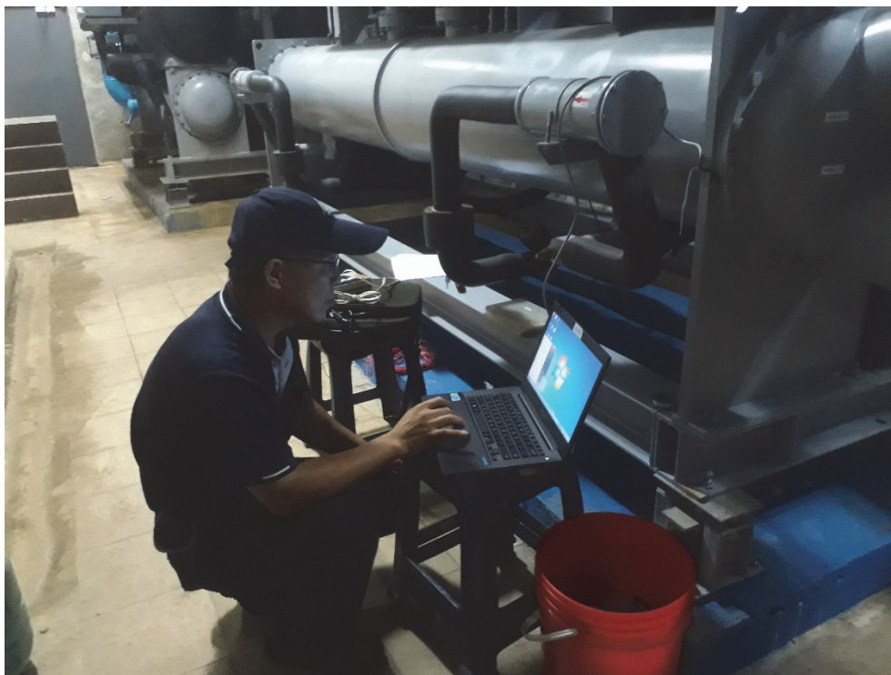
圖 4-9 G 醫院冰水主機軟體方面之修改與精進--- 主機控制軟體修改(1)
