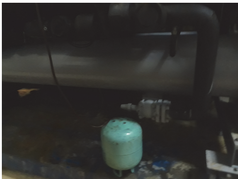
圖 4-4 G 醫院冰水主機硬體方面之修改與精進--- 冷媒回收與高低壓調整
