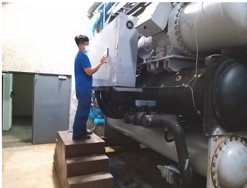
圖 4-12 G 醫院冰水主機硬體與軟體方面之修改與精進完成後之系統試俾(2)
