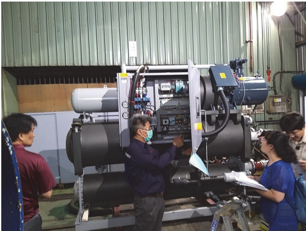
圖 3-6 進行廠測前先確認冰水主機系統各項諸元
