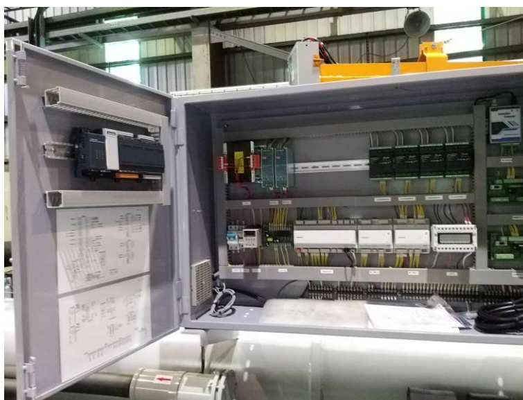
圖 3-2 大型建築空調主機系統結合 IoT 設計之系統硬體裝置前情形 (資料來源：本研究整理)
