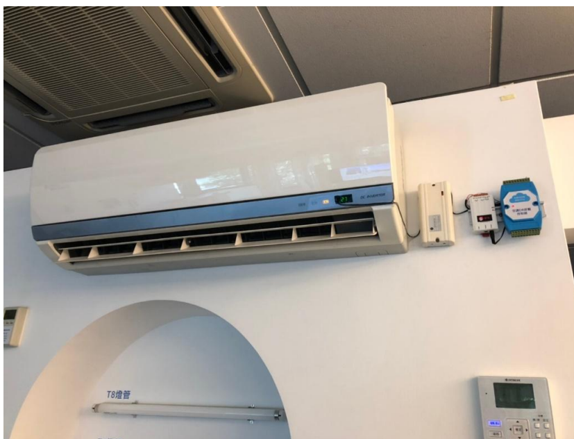
圖 3-11 小型建築空調系統結合 IoT 物聯網之裝置完工情形 (資料來源：本研究整理)
